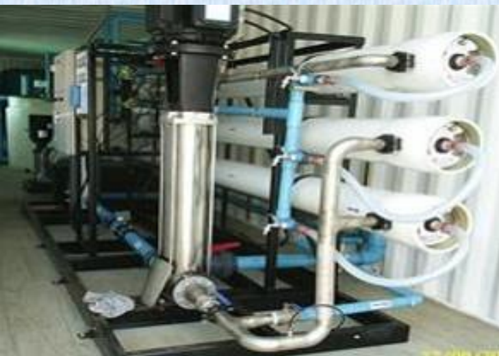
Tratamiento Químico del Osmosis Inversa
